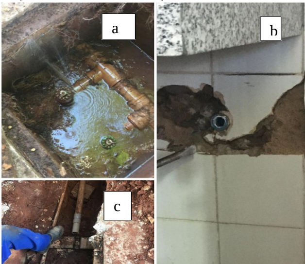
Figura 07 – Manutenção hidráulica. a) caixa com encanamento estourado no fundo do banheiro, b) encanamento dentro do banheiro masculino com piso quebrado, c) quebra da calçada atrás do banheiro para arrumar encanamento. Troca de Reparo em encanamento.
