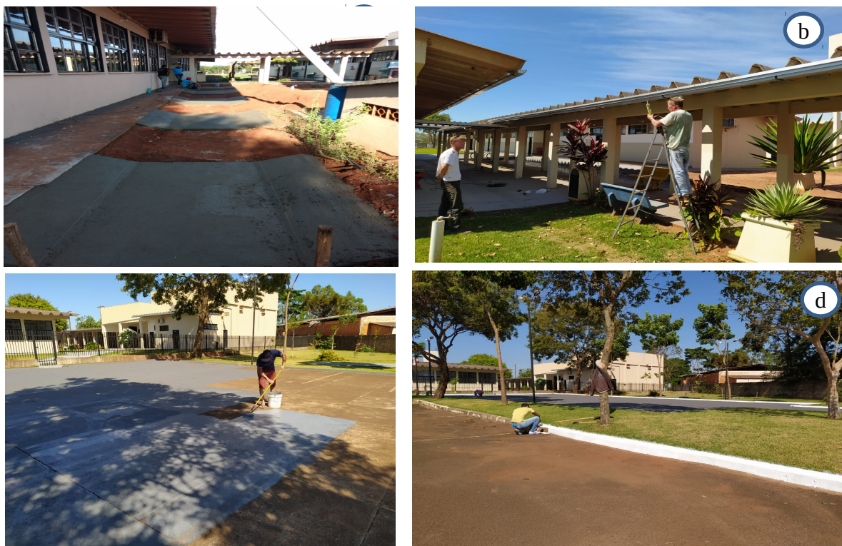
Figura 08 – Reformas e melhorias da UU de Mundo Novo. a) Drenagem pluvial; b) Calhas; c) Pintura do estacionamento; d) Pintura meio-fio do estacionamento.
