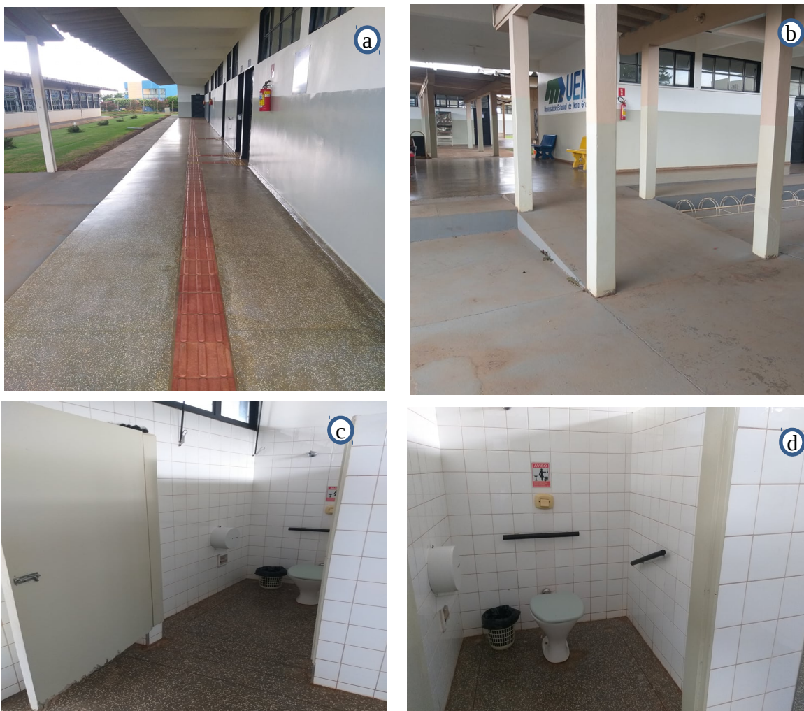
Figura 11 – Fotografias dos ambientes e instrumentos de acessibilidade da UU de Mundo Novo a) piso tátil; b) rampa de acesso às salas de aula; c) e d) sanitários adaptados.
