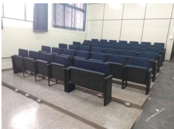
Figura 26 – Sala PÓS PGRN: Preparação de piso para instalação de poltronas - UU Dourados.
