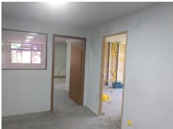
Figura 32 – Reitoria (sala vice/ACS/PJU): reestruturação física pintura, rede lógica, telefônica, instalação elétrica nova - UU Dourados.
