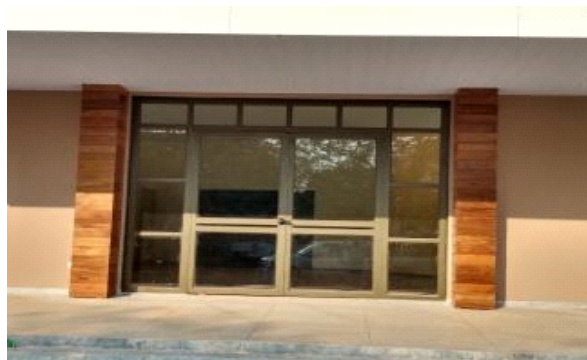
Figura 06 – Auditório: Instalação de estrutura em madeira para cobrir canos de escoamento de águas fluviais – UU Dourados.
