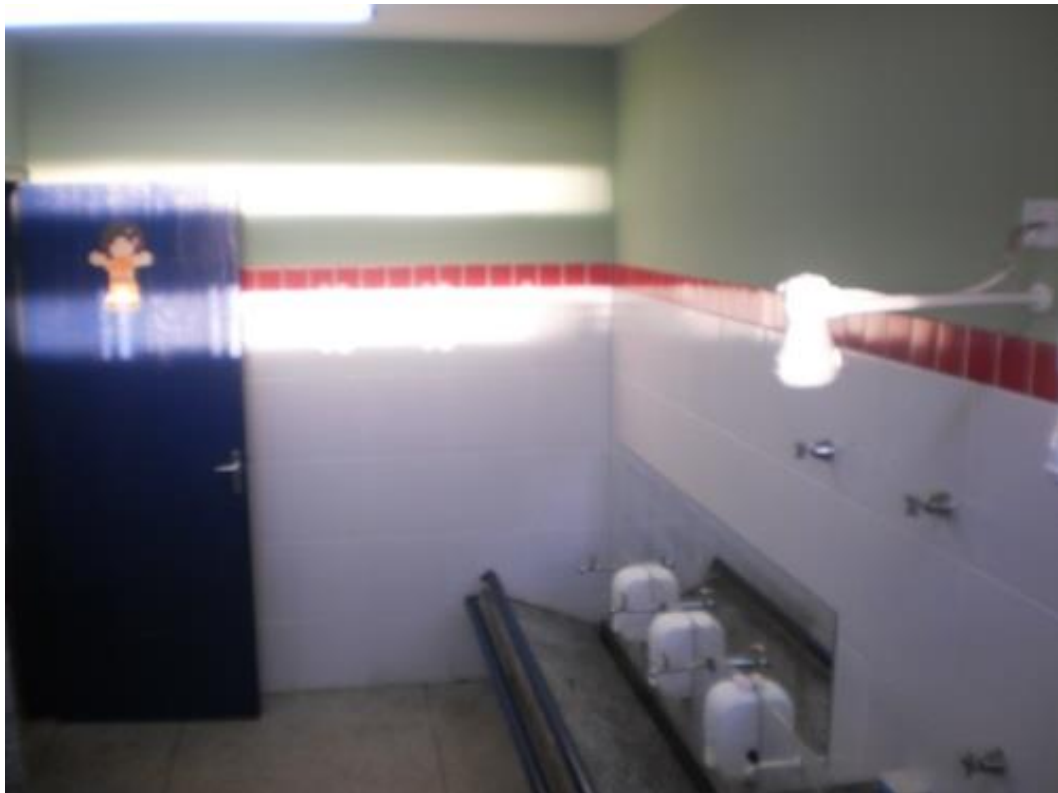
Figuras 12A : Organização dos espaços do Proinfância: Banheiros
