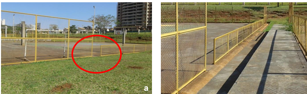
Figura 15 - Quadras poliesportivas: a) Acesso à quadra sem pavimento (destaque); b) Diferença de nível entre uma quadra e outra (destaque) Fonte: Autora, 2016
