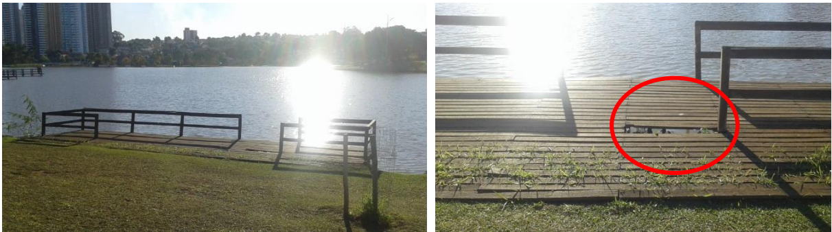
Figura 16 - Embarcadouro: a) Acesso sem pavimento (destaque); b) Estrutura danificada (destaque) Fonte: Autora (2016)
