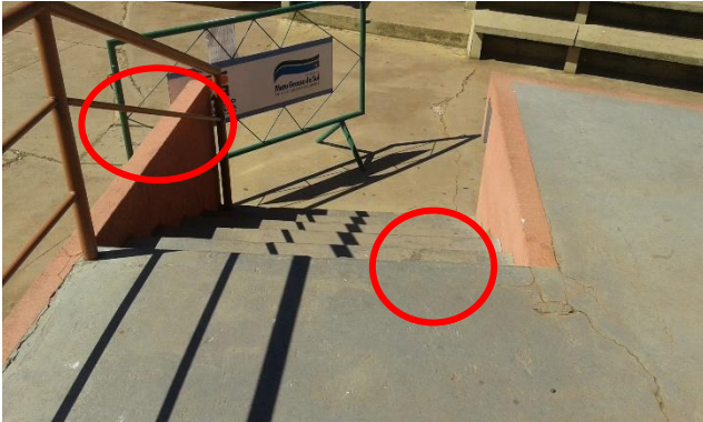
Figura 8 - Acesso ao palco da Concha Acústica: destaque para o corrimão unilateral na escada de acesso ao palco e ausência de sinalização dos degraus Fonte: Autora, 2016
