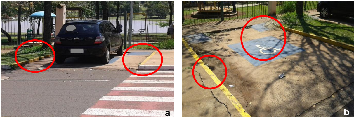
Figura 19 - Vagas especiais portão Guató : a) Dimensão da vaga especial com veículo estacionado (destaque) e o espaço adicional de circulação; b) Sinalização horizontal, em destaque guia sem rebaixamento e rampa posicionada de forma incorreta.
