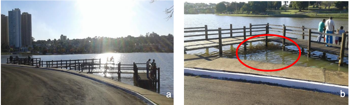
Figura 2 - Deques: a) Vista geral; b) Calçada sem guarda-corpos (destaque) Fonte: Autora, 2016
