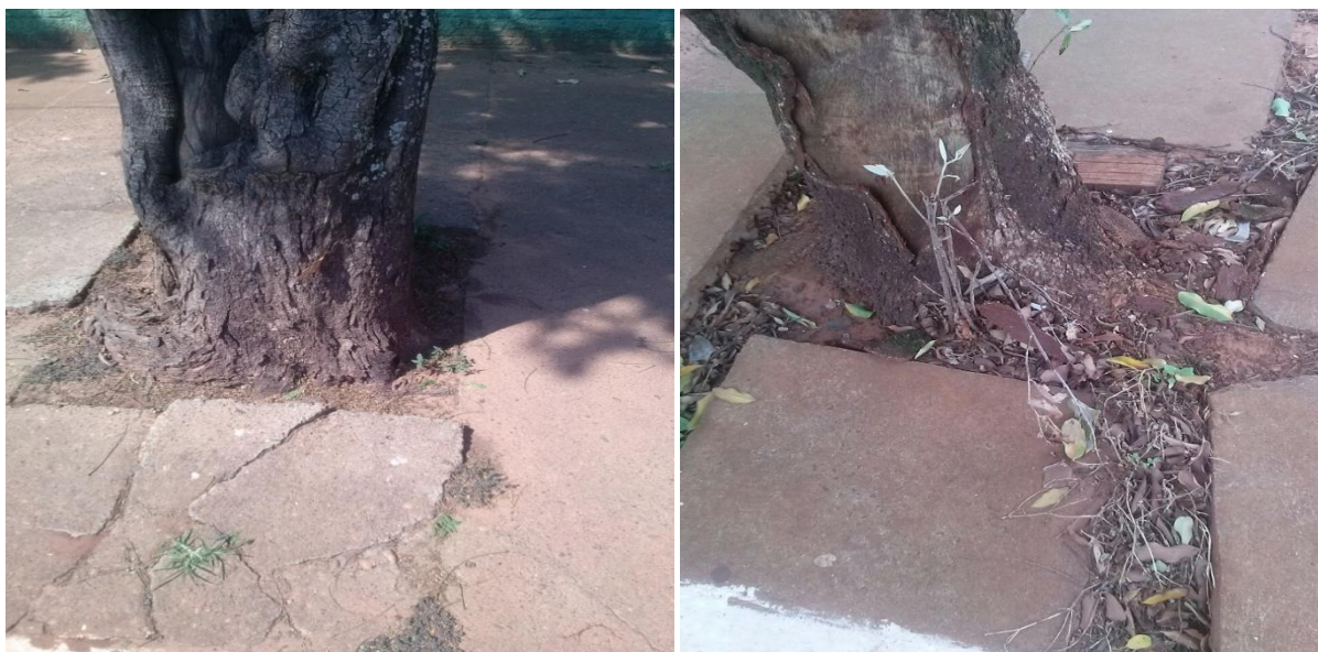
Figura 13. Calçada da Avenida Industrial e Avenida 13 de Maio danificada pelo crescimento Radicular da C. peltophoroides .
