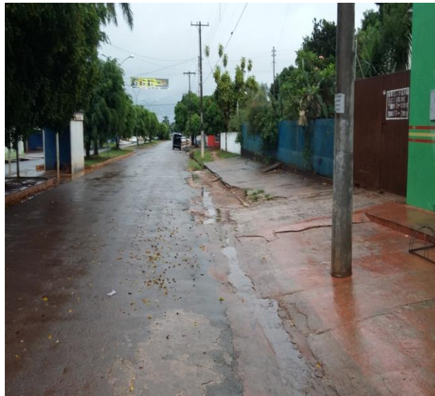
Figura 18. Desnível das calçadas Fonte: Mendes, 2015
