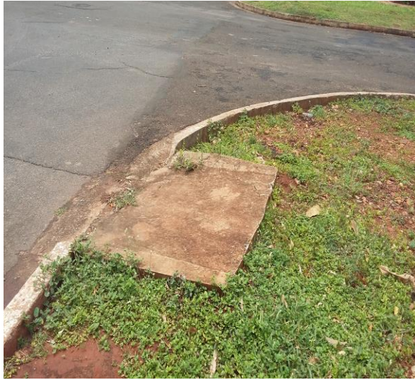
Figura 24. Rampa em local inapropriado
