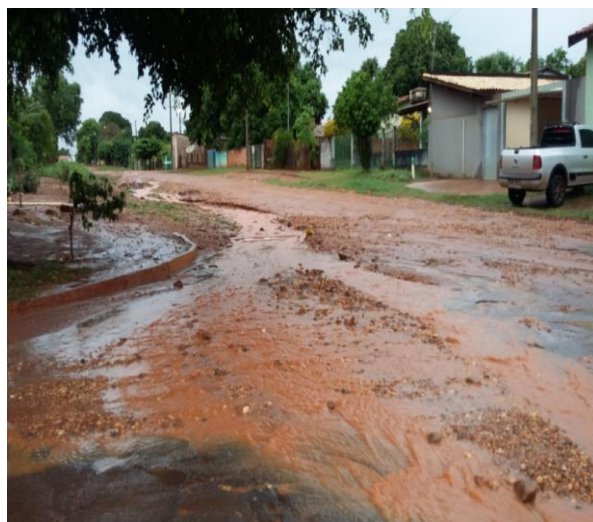
Figura 17. Acúmulo de sedimentos na pista
