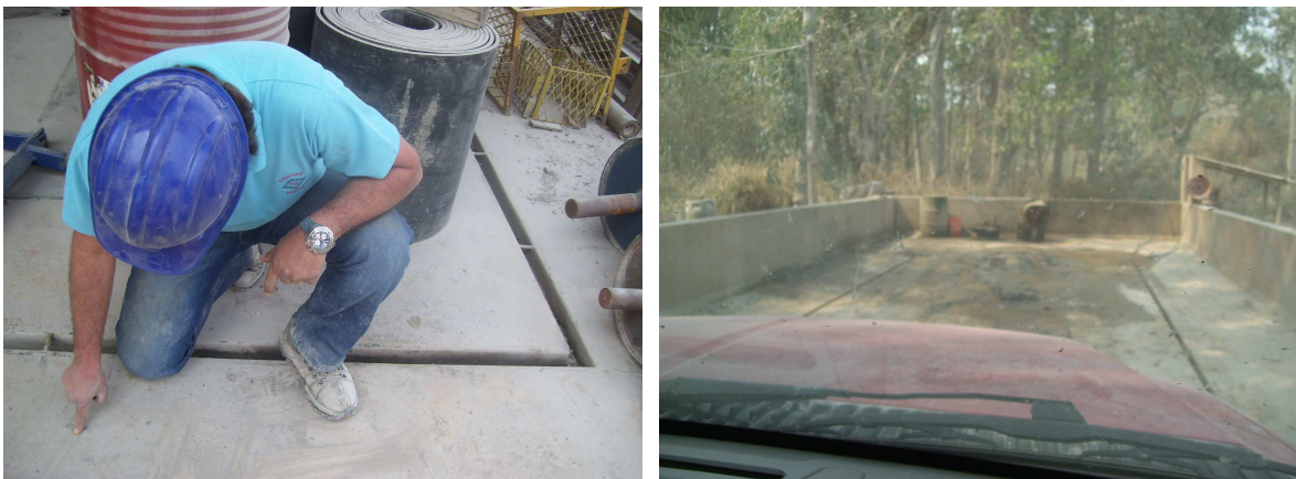
Figuras 29 e 30: Fotos de canaletas coletoras de óleo no piso da oficina e lava-jato Autor: Ilzo Audício Meireles.
