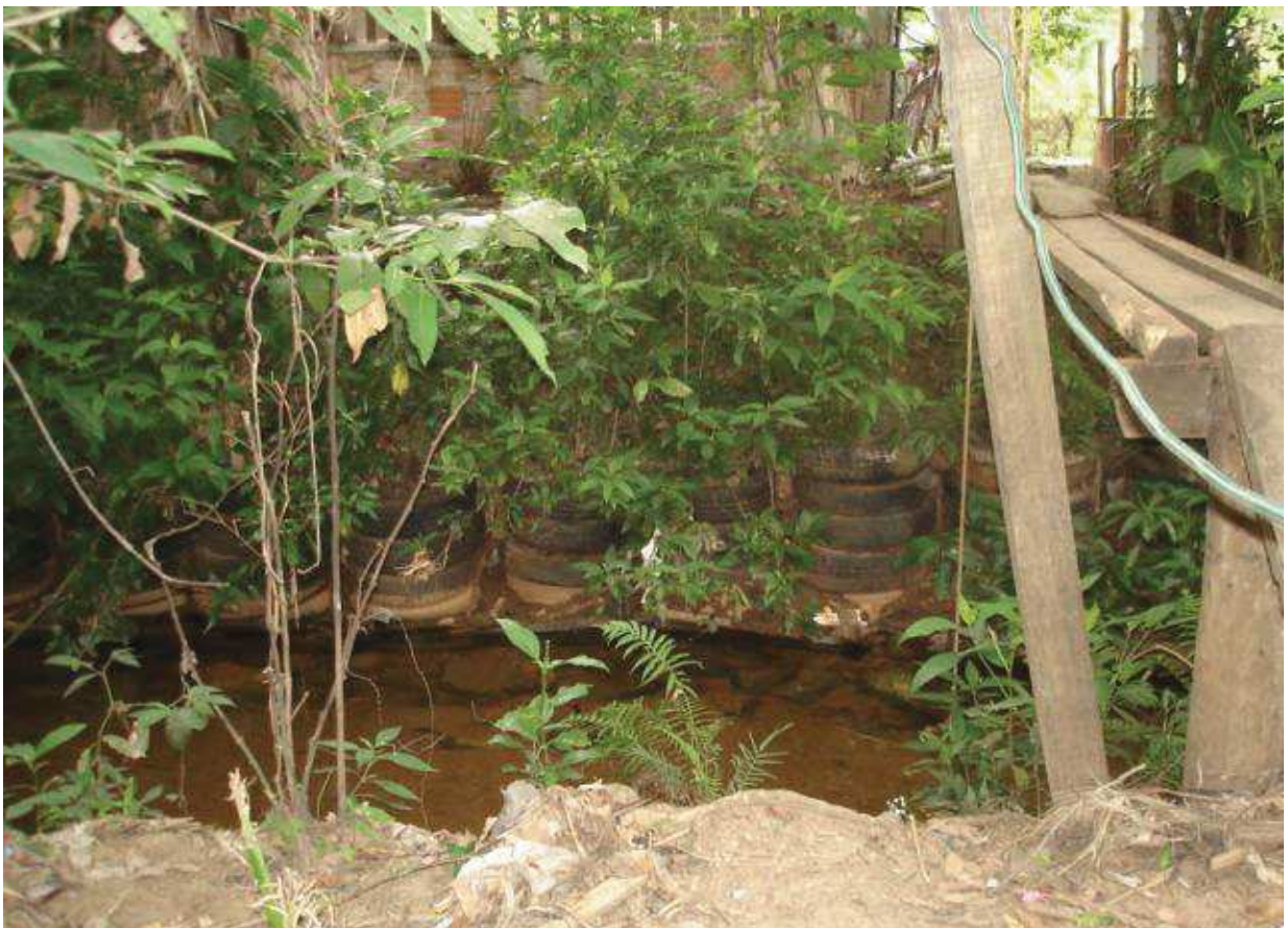
Figura 25 - Barragem de pneus instalada na margem direita do córrego Restinga nas proximidades da rua Nelson Felício.
