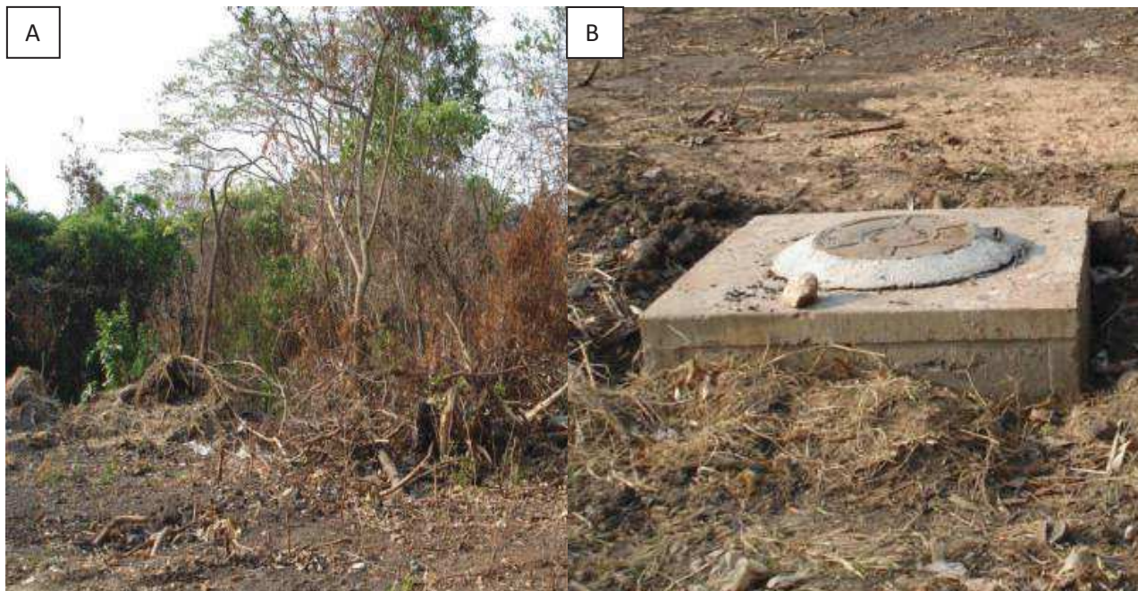
Figuras 17 - Áreas de construção de galerias próximas ao córrego Restinga. A - imagem retrata a retirada a cobertura vegetal para implantação da rede de esgoto; B – Detalhe do ponto de vistoria de rede de esgoto instalada ao longo do vale do córrego Restinga.
