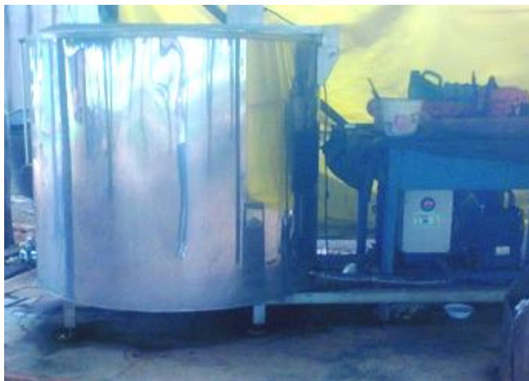
Foto 3: Resfriador de Leite com Capacidade de 1.000 litros.
