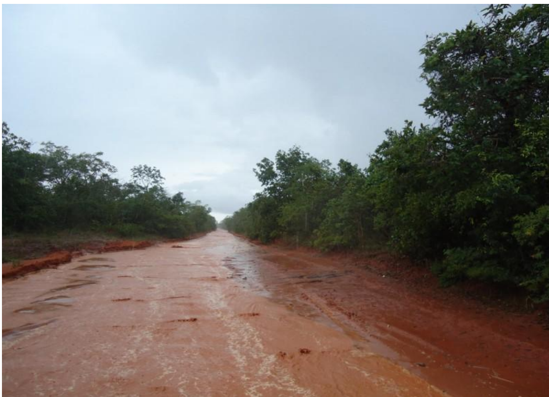
Figura 04 - Erosão laminar. É causada pela água da chuva. Estrada rural em processo erosivo tipo laminar, onde água retira uma fina camada do solo.
