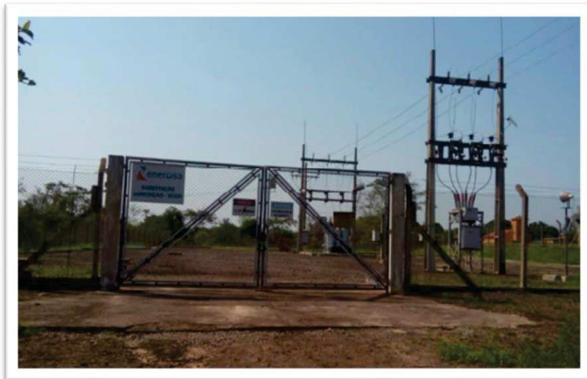
Figura 3: Subestação elétrica do assentamento Conceição.
