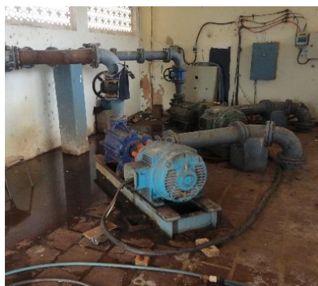
Figura 12. Sistema motor bomba da Sanesul no município de Mundo Novo/MS
