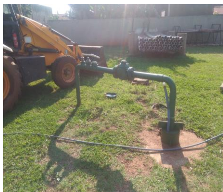
Figura 16. Poço artesiano MUN 004.
