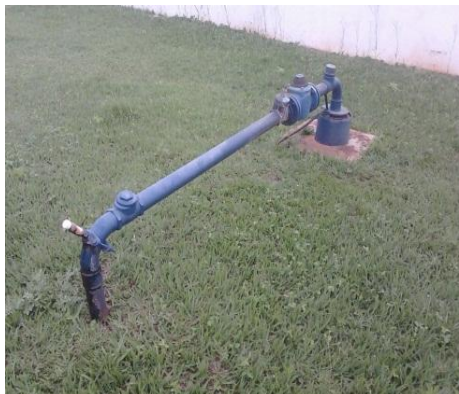
Figura 14: Poço artesiano MUN 003
