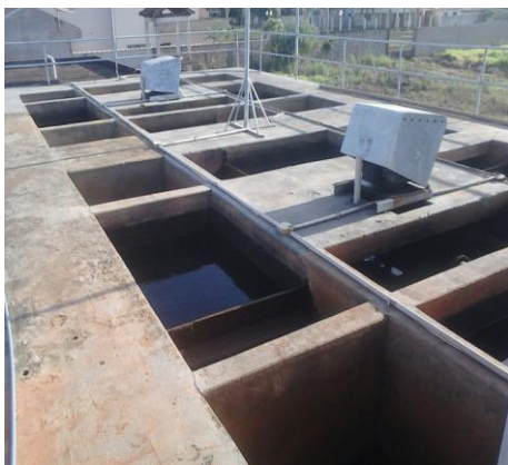
Figura 7. Decantadores da E.T.A da Sanesul no município de Mundo Novo/MS.
