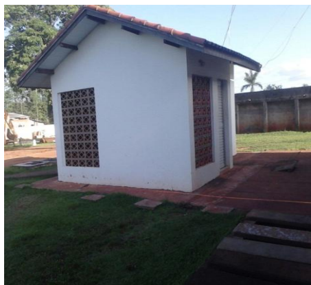
Figura 6. Casa de cloração e fluoretação da Sanesul no município de Mundo Novo MS.
