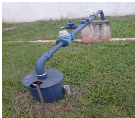
Figura 13. Poço artesiano MUN 002.
