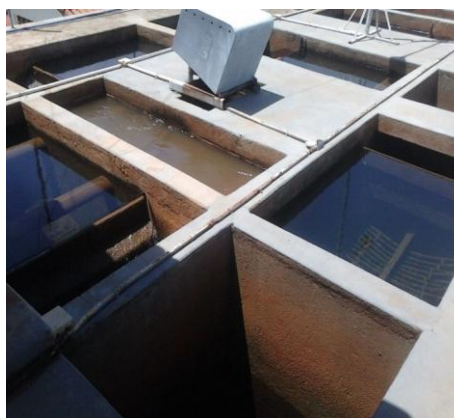
Figura 8. Decantadores, filtros e floculador no município de Mundo Novo/MS.
