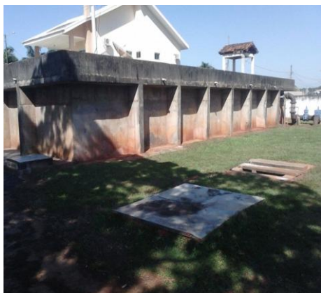
Figura 5. Reservatório apoiado da Sanesul no município de Mundo Novo MS.
