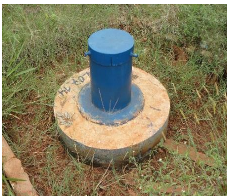
Figura 18. Poço artesiano MUN 006.
