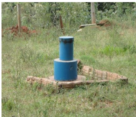
Figura 19. Poço artesiano MUN 007.
