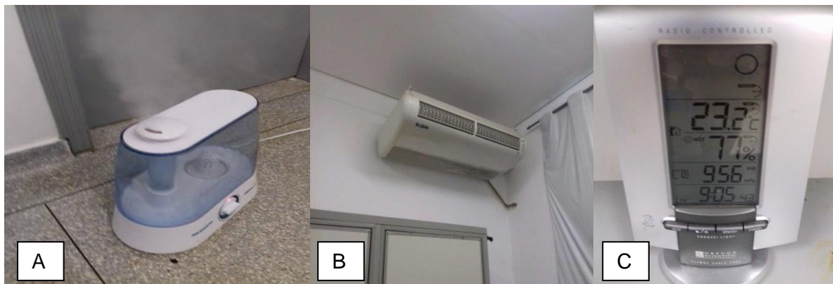
FIGURA 1 - Sala climatizada para a criação massal de Spodoptera . A) Umidificador de ar. B) Ar Condicionado. C) Medidor de umidade de ar
