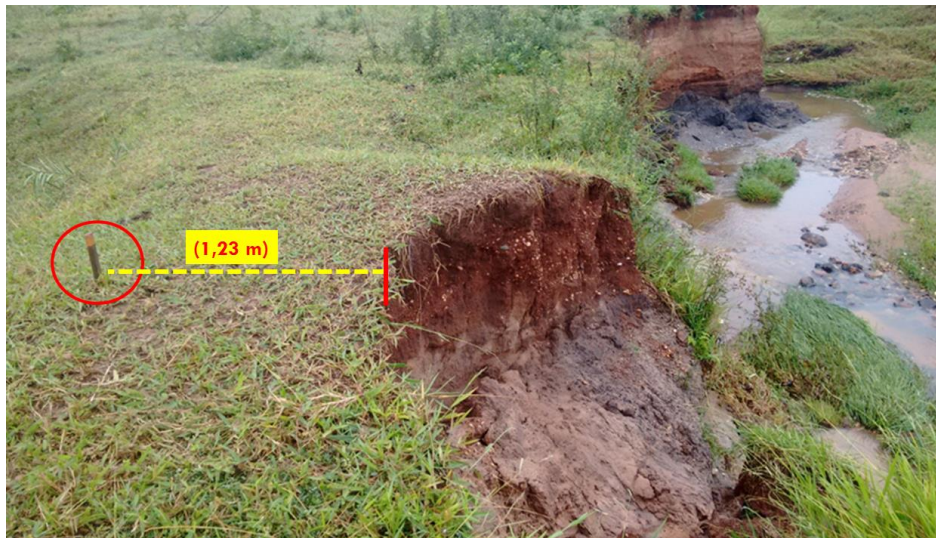
Figura 26 - Seção de monitoramento – 04, em maio/2017. Destaque para estaca de madeira cuja distância inicial de 3 metros do talude foi reduzida pela erosão à pouco mais de um metro.
