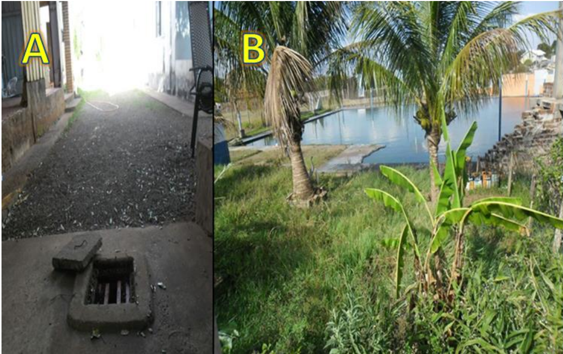
Figura 7 – Galeria de captação de água da nascente. A- A galeria representa local de drenagem da nascente. B- Piscinão com armazenamento da água represada da nascente do Córrego Grotão. Fonte: BOEIRA (2014).
