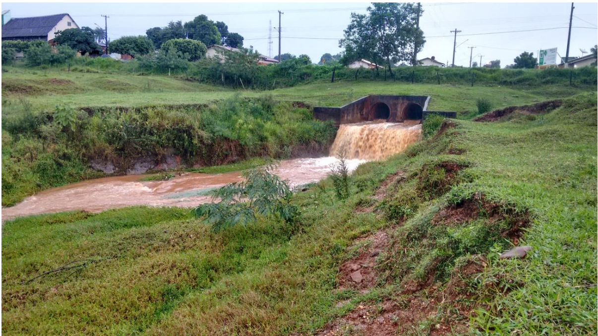
Figura 18 - A drenagem do fluxo da nascente causa à diminuição da quantidade de vazão de água do Córrego Grotão, causando a degradação, e em períodos de chuvas aumenta o escoamento de enxurradas arrastando todo tipo de lixos e dejetos que ficam alojados nas margens do Córrego.
