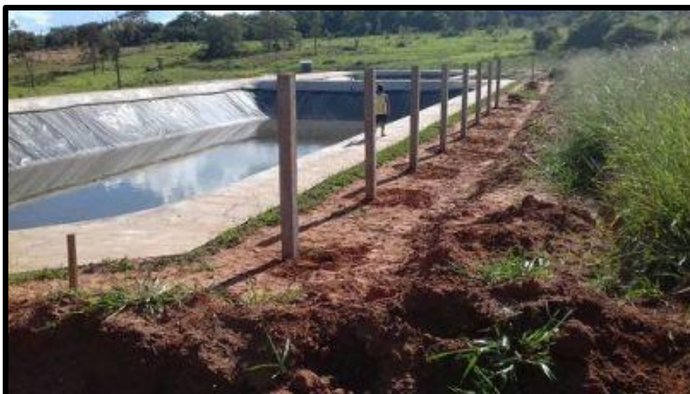
Foto 08: Vista parcial de um dos tanques de deposição do aterro sanitário de Jardim/MS Fonte: Durigon (2017)
