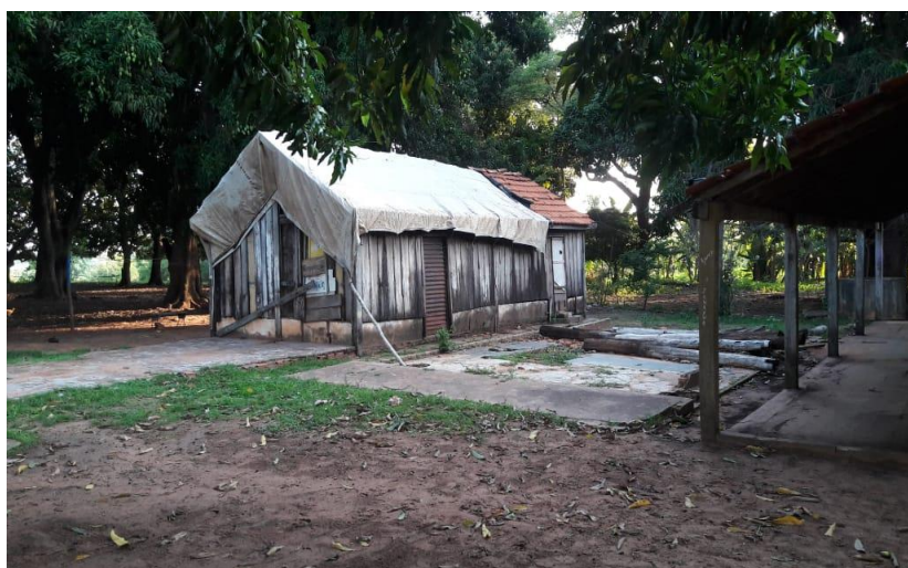
Foto 4: Estrutura da sede da fazenda Palmeira, atualmente condenada Fonte: SILVA, J. A. pesquisa de campo, 2018.
