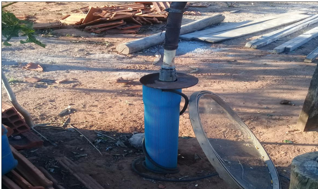
Figura 6: Bomba de água do poço semi-artesiano do Assentamento Arataba. Fonte: ALCARÁ, 2018.
