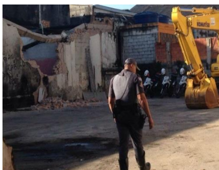
Escavadeira da prefeitura atingiu parede de pensão com moradores ainda no local
