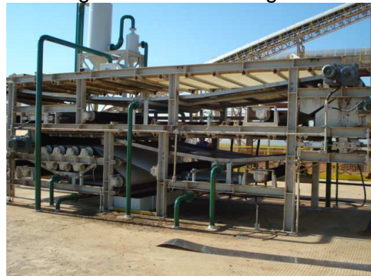
(B) Filtro esteira para remoção de água da lama de fuligem.
