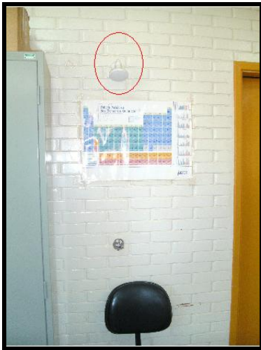
Figura 18 - Chuveiro obstruído (ago/2012).
