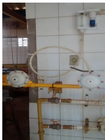
Figura 9 - Dosador de cloro
