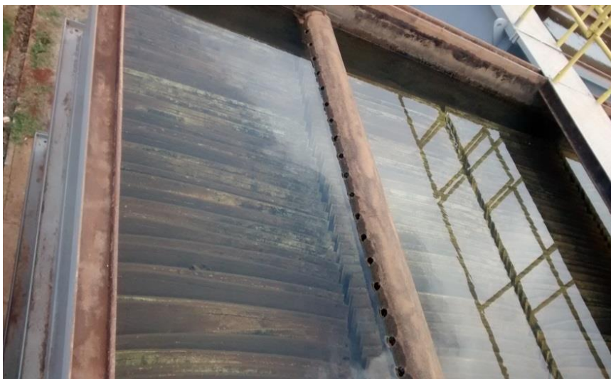
Figura 5 - Decantador com placas de PVC
