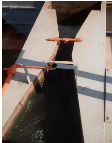
Figura 4 - Calha Parshall onde é realizada a dosagem do polímero
