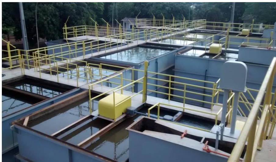
Figura 2 – Visão geral da Estação de Tratamento de Água da cidade de Dourados
