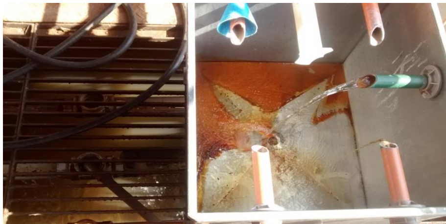
Figura 3 – Sistema de adição do sulfato de alumínio líquido
