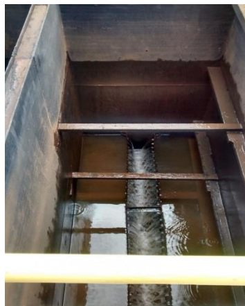
Figura 7 – Etapa de lavagem do filtro em contracorrente
