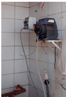
Figura 10 - Dosador de flúor
